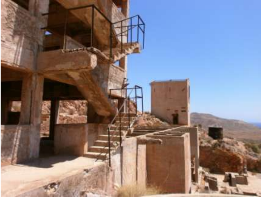
Ilustración 03. Inestabilidad estructural en la escalera exterior de la casa de cribas. Autoría: Isabel Rueda Castaño
